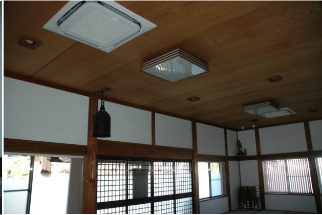
天井には天吊四方吹出しの室外機二台を設置
