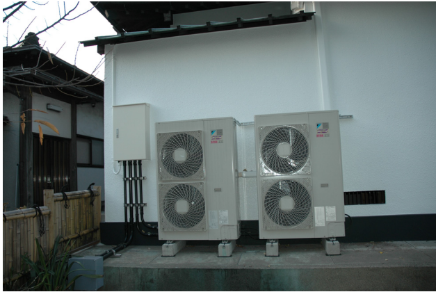
新規に設置された電源ボックスと室外機
